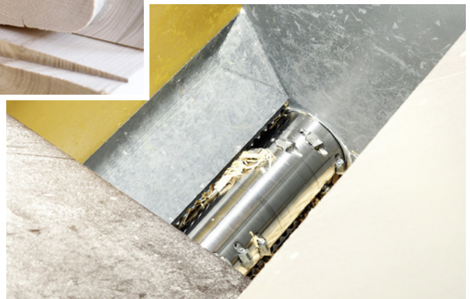
Einfache Entsorgung: Kostka entschied sich für einen Hacker direkt unter der K2-Industry, das vereinfacht die Restholzentorgung enorm
