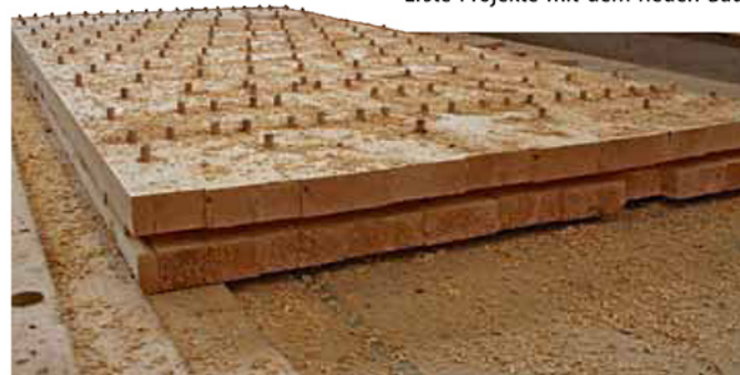
Nach dem Verschrauben gelangen die Platten zu einem Hundegger-Portal-BAZ, wo die überstehenden Schraubenköpfe abgefräst werden
